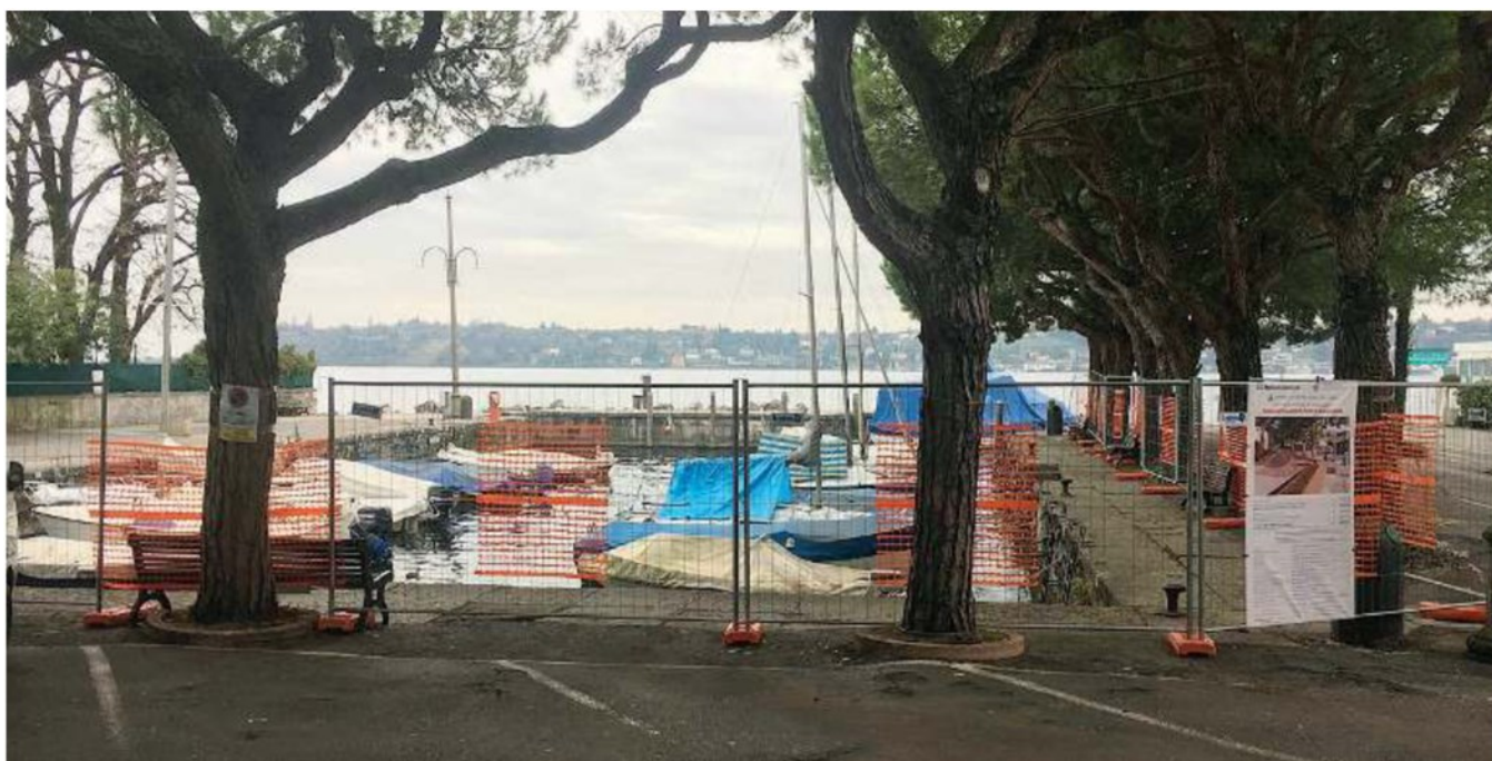
Arriva la pavimentazione in porfido. Parte oggi il cantiere da 350mila euro per riqualificare il porto di Barbarano a Salò
